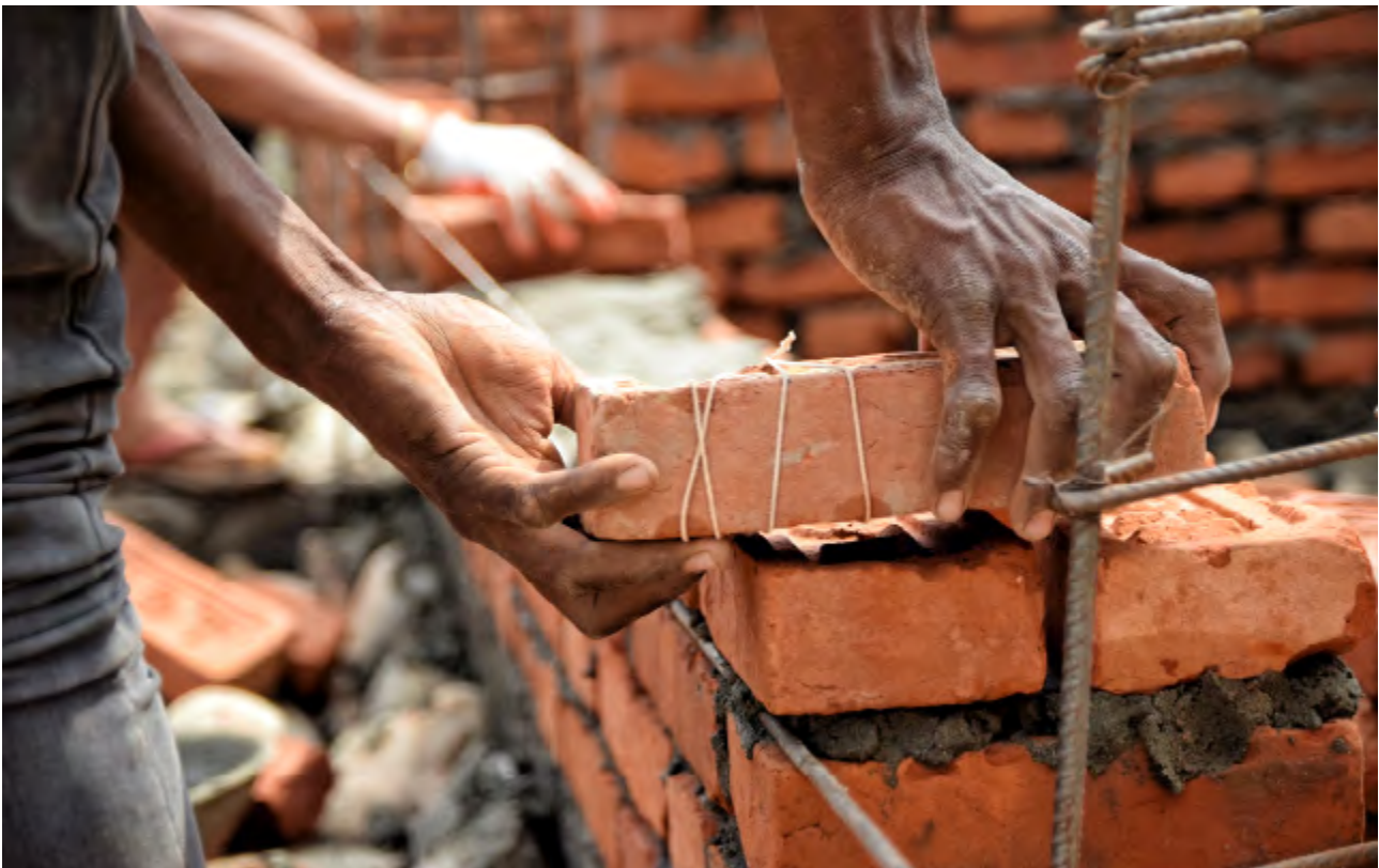
Fig. 3: © Bria Fast. Népal, 2016. Un maçon pose des briques lors de la reconstruction d'une maison après le tremblement de terre au Népal.
